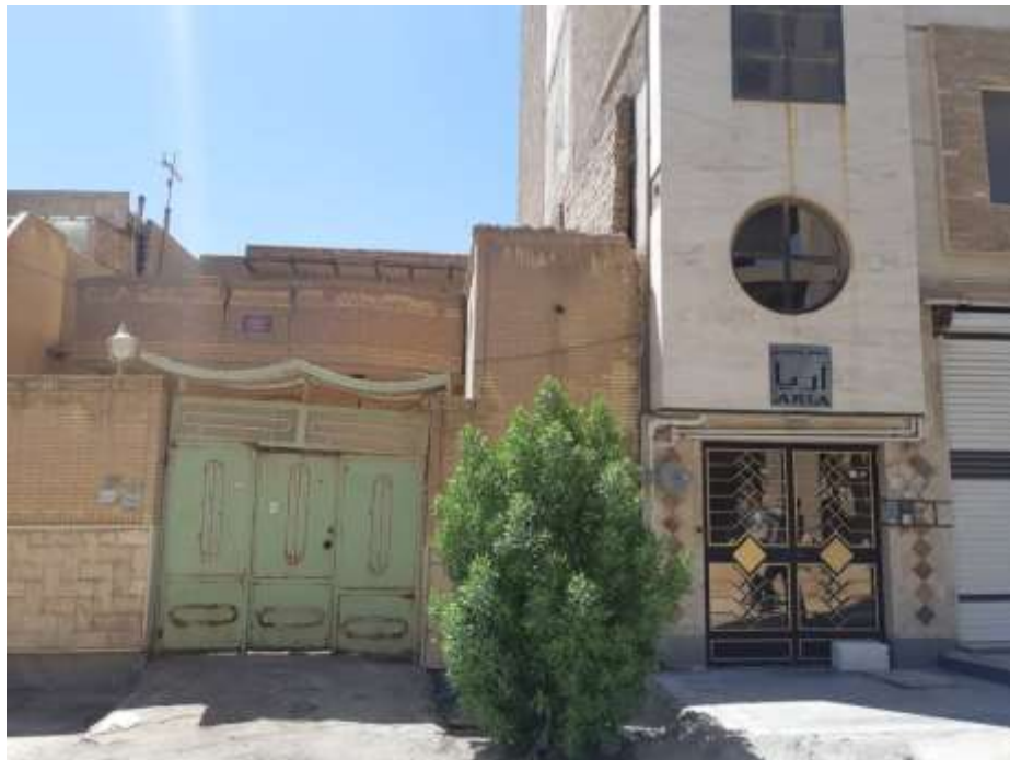
تصویر ۲-۲ بروز نشست غیریکنواخت و آسیب‌زدن به ساختمان مجاور، ساختمان روبروی شهربازی، شهر آبادان
